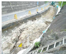
平成20年5月 7日 2. 滝ノ沢L21(国道開口) 歩道部分の陥没
