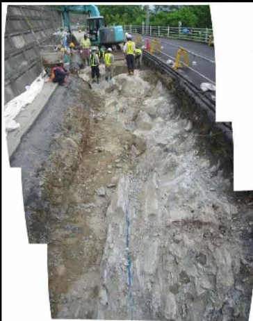
3. 左側土砂部は古い開口亀裂と思われる。
