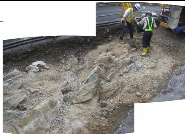
4. 碎石が充填された開口亀裂。
