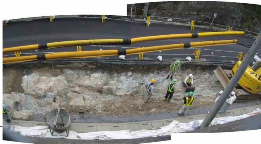
2. 開口部には砕石が充填されている。
