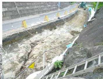
平成20年5月 7日 3. 滝ノ沢L21（国道開口） 歩道部分の陥没
