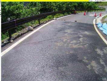
平成20年4月14日 5. 遊仙橋地区（R20） 市道の亀裂
