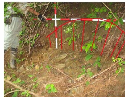
11. 比較的新しい小崩壊。H=0.5m
