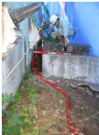
7. 土塊が約0.2m移動している。
