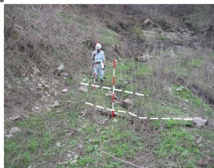
15. 里道に認められる2条の亀裂。
