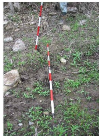
16. 里道の亀裂(拡大)。
