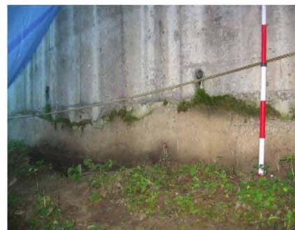
5. 頭部開口亀裂。谷側の土壌が約0.4m沈下している。
