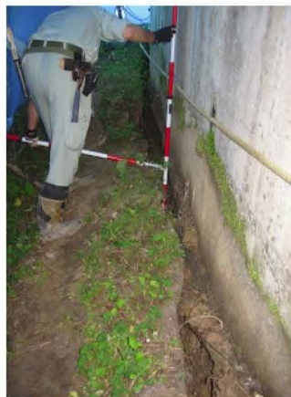
4. 頭部開口亀裂。D=約0.6m。 擁壁基礎前面に連続した開口亀裂。
