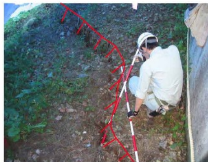
8. 下流側側方部へと延びる段差亀裂。
