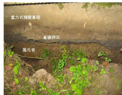
6. 擁壁基礎部。砕石下面には風化岩が認められる。
