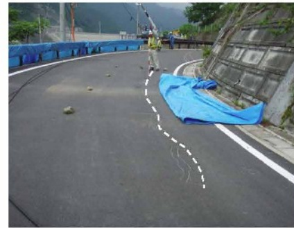
3. 付替市道上に発生したクラック。 拡大傾向は認められない。
