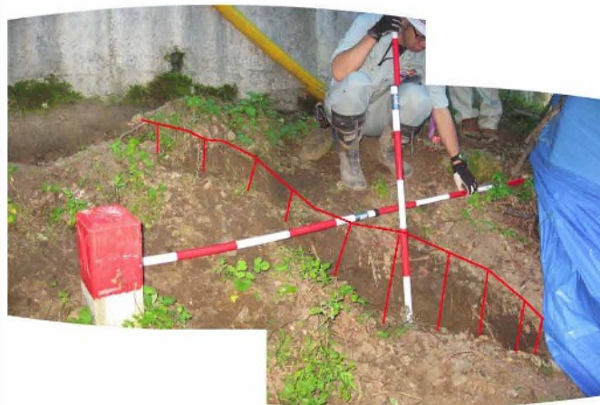
10. 上流側側方部へ延びる段差亀裂。
