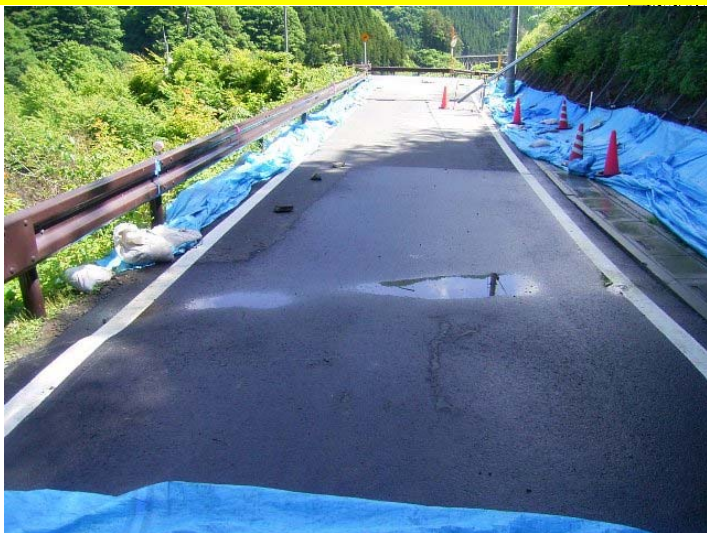
平成20年4月 3日 4. ノウ沢下流地区 (R23) 市道の亀裂・沈下
