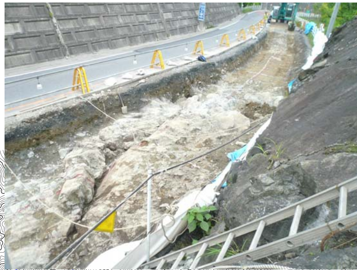
平成20年5月 7日 3. 滝ノ沢L21(国道開口) 歩道部分の陥没
