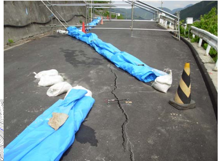
平成20年5月 9日 2. 滝ノ沢下流地区 管理用道路の亀裂・沈下
