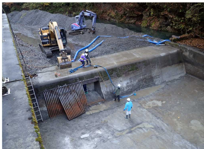
取水堰洗掘箇所全景
