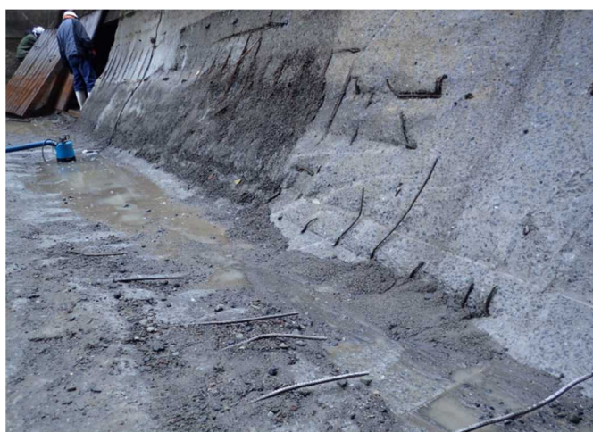
コンクリート磨耗状況
