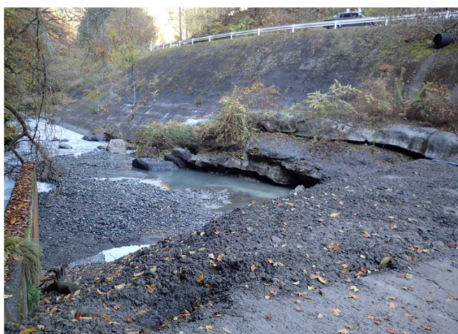
護床ブロックの損傷
