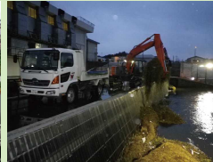
ポンプ運転時のスクリーン除塵
