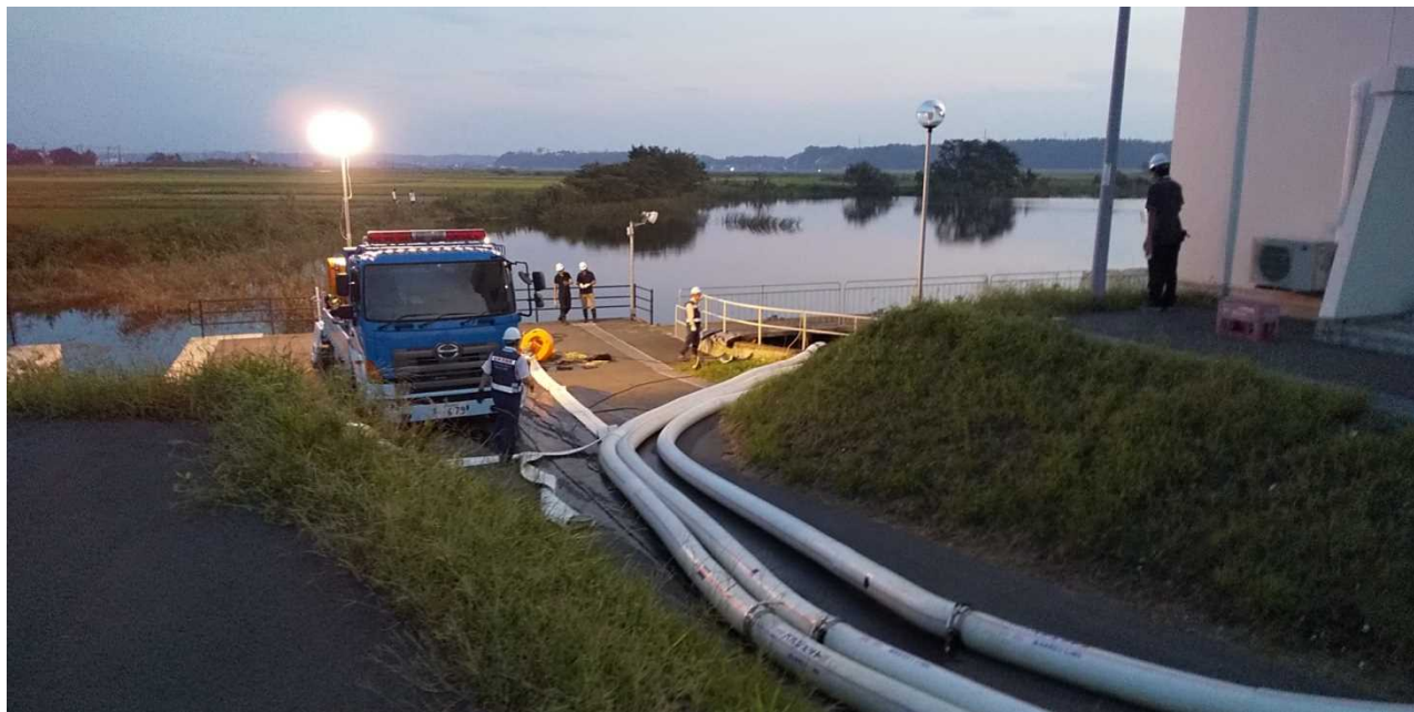
水資源機構が所有する排水ポンプ車と配管作業状況
