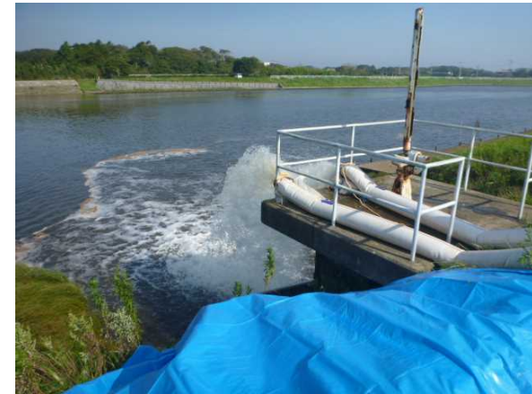
屋形排水機場からの排水状況（10日～）
