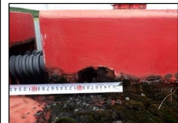
鋼材部腐食箇所
