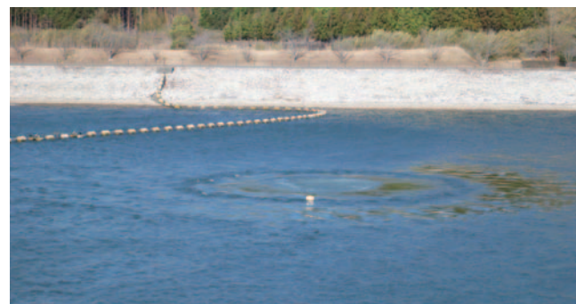
東金ダム貯水池曝気設備運転状況
