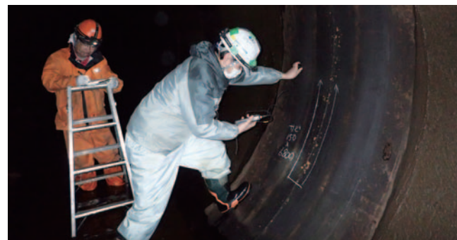
ストックマネジメントのための調査（トンネル鋼管の腐食状況）
