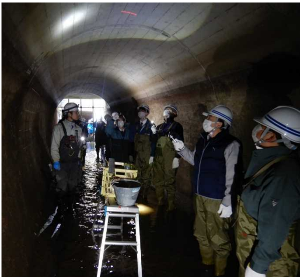
米野暗渠のひび割れを見て頂きました
