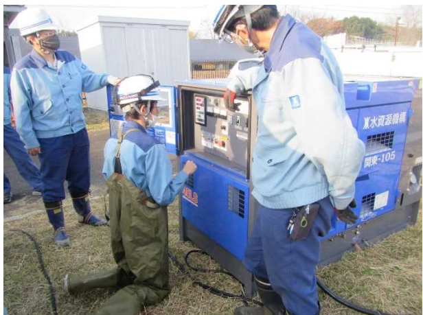
発電機の操作（電源の確保）
