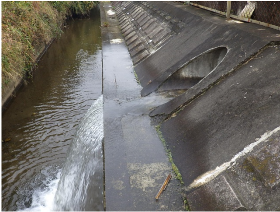
ゲートからの自然排水中
