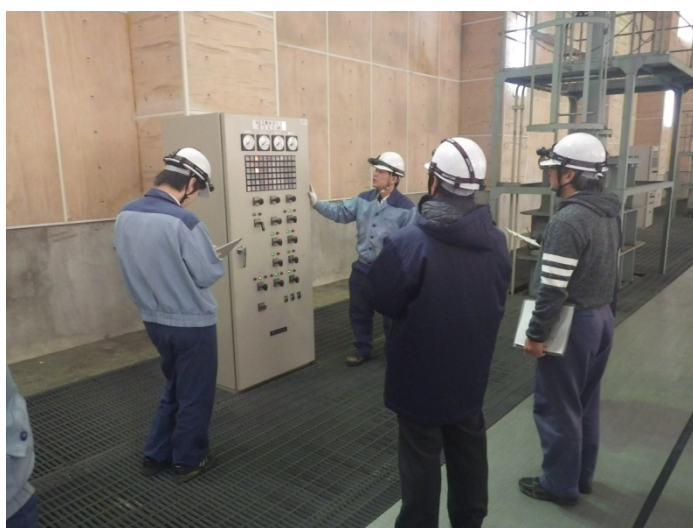
【揚水ポンプ操作盤復旧方法の説明】
