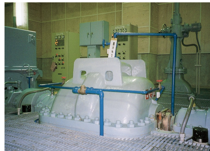
▲ポンプ近景（うず巻ポンプ）
