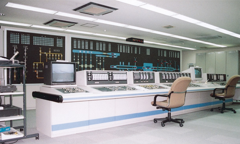
▲監視盤・操作室
