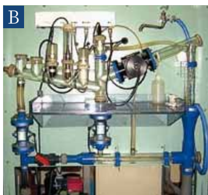
■水質自動監視装置
