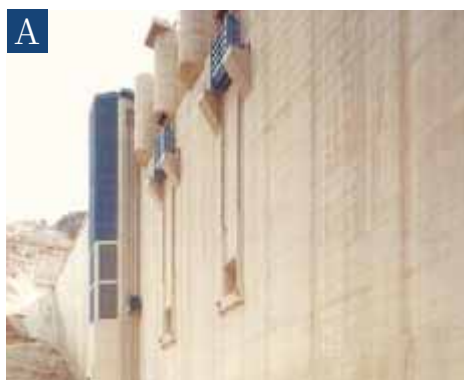
■表面取水設備
