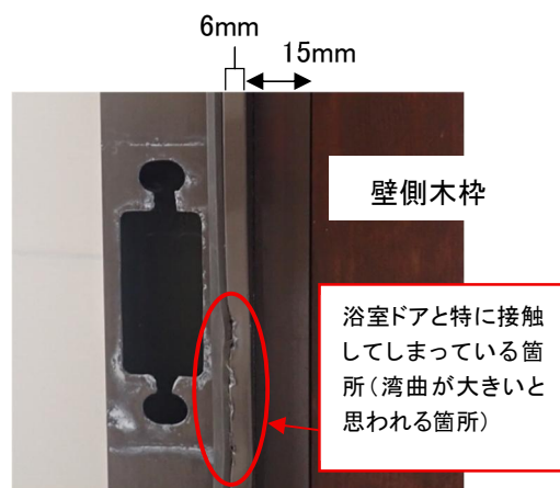
○壁側アルミ枠の浴室ドアとの接触部近景
