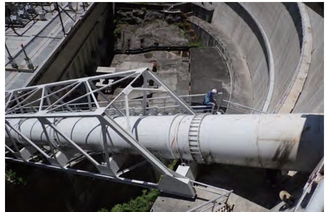
アーチダムから突き出す放流管。その先にはホロージェットバルブが設置されています。(矢木沢ダム)
