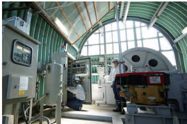
奈良俣ダム洪水吐ゲート内の電気設備等。いつも正常に動くように点検作業は欠かせません。
