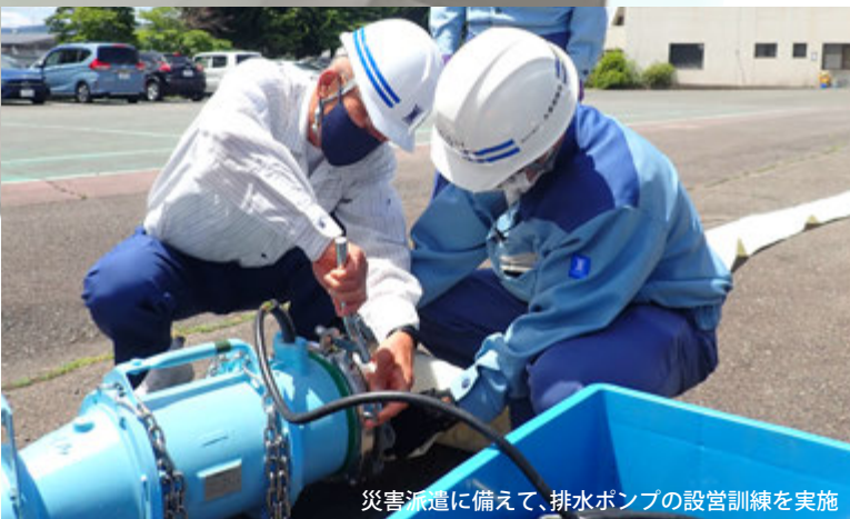
災害派遣に備えて、排水ポンプの設営訓練を実施
