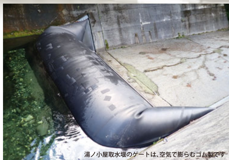
湯ノ小屋取水堰のゲートは、空気で膨らむゴム製です
