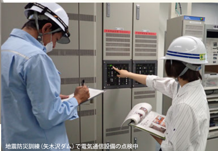
地震防災訓練(矢木沢ダム)で電気通信設備の点検中
