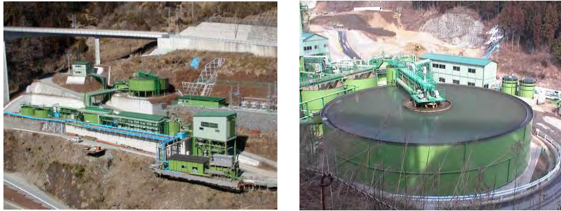
濁水処理設備（滝沢ダムの事例）
