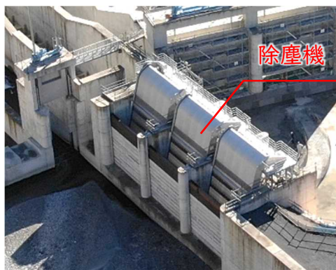
写真-3 除塵機 (大芦川取水放流工)
