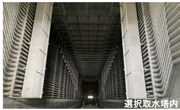
選択取水塔内
