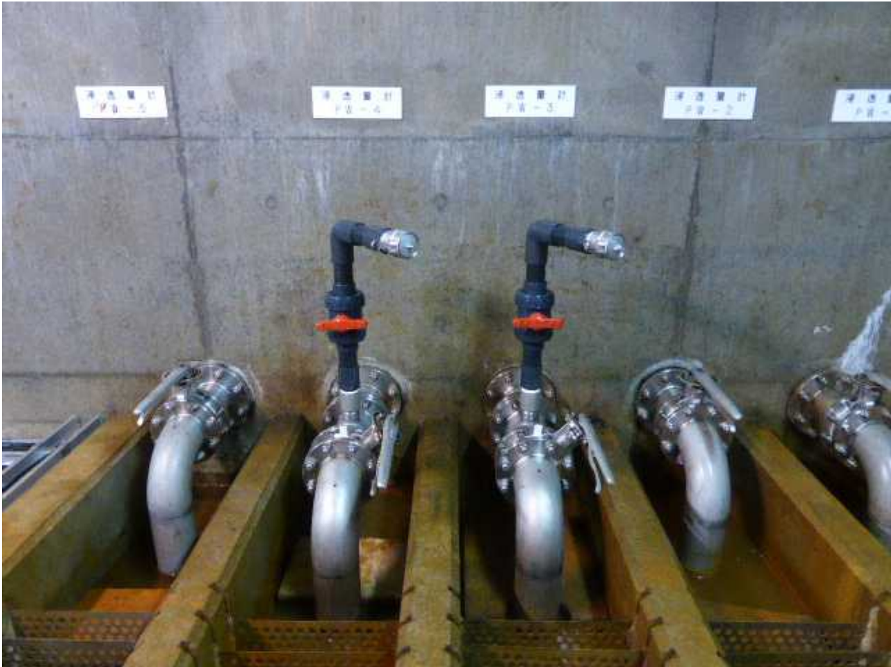
導水管 (管径150mm)
