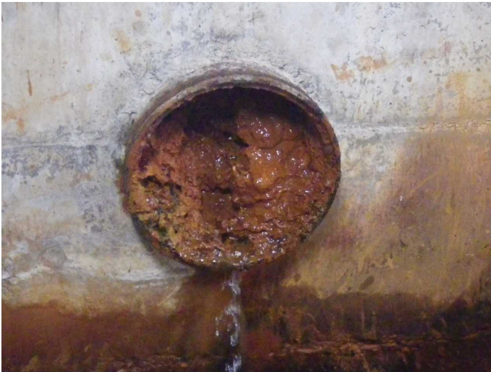
平成30年度にフランジ管を交換した際の管内状況(管径150mm)
