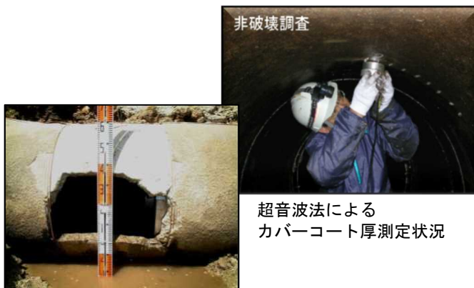
PC 管の管体破損事故事例
