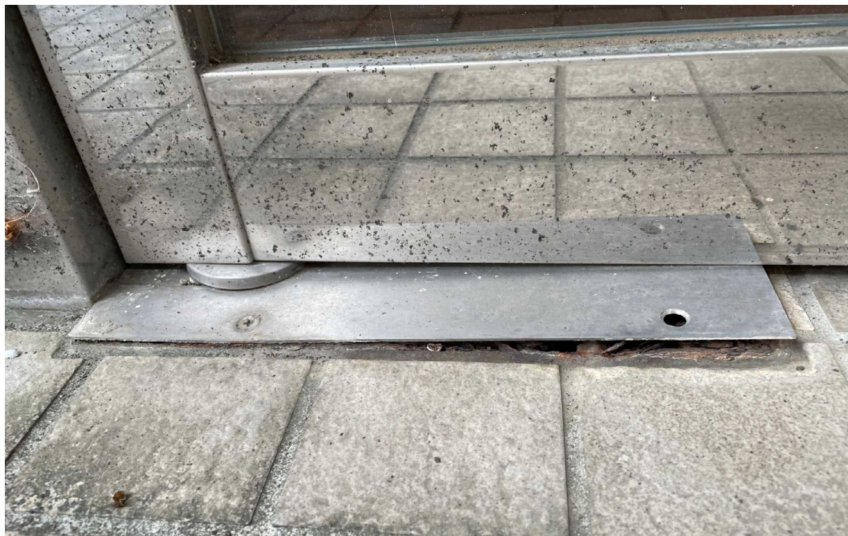
○フロアヒンジの現況写真（２） ※浮き上がり部の拡大図
