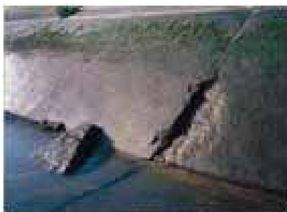
【水路内の欠損・クラック】
