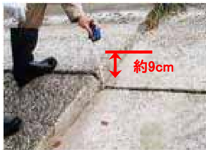
【水路内の段差】
