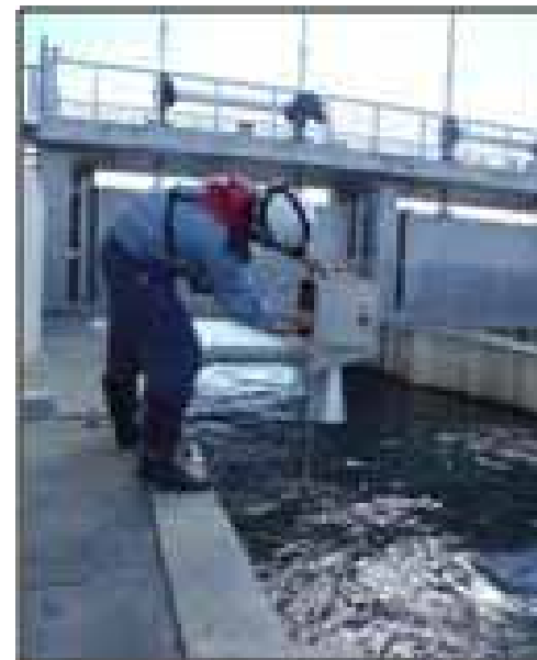
電気設備点検の実施状況(荒木制水ゲート)
