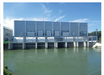
糠田排水機場
