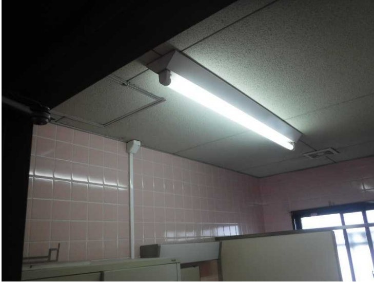
2階 シャワー室(⑥:1基、⑯:1基)
