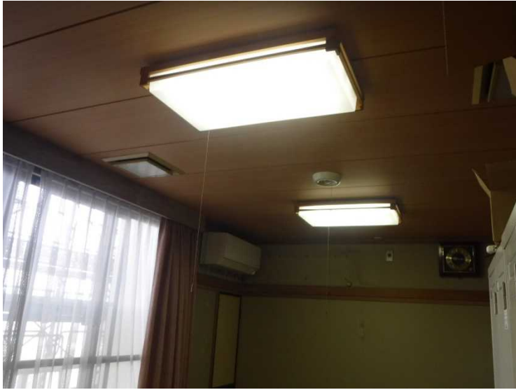
2階 ロッカー室(④:1基)
