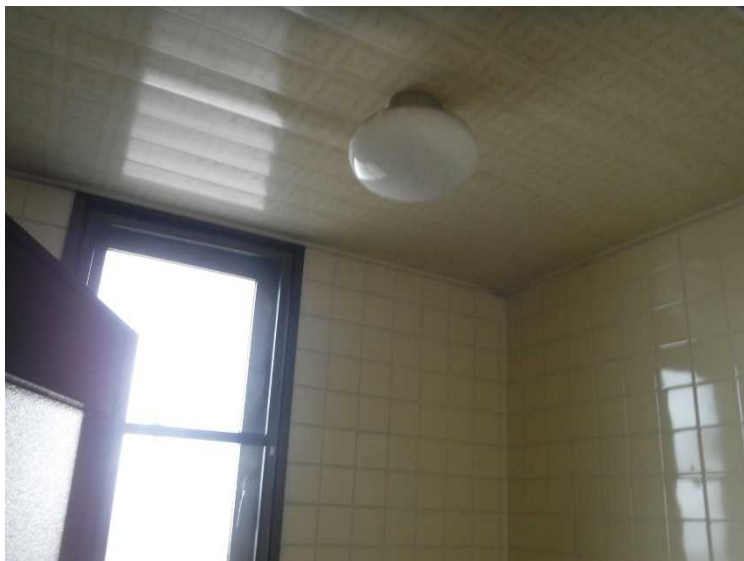
1階 階段下(⑲:1基)
