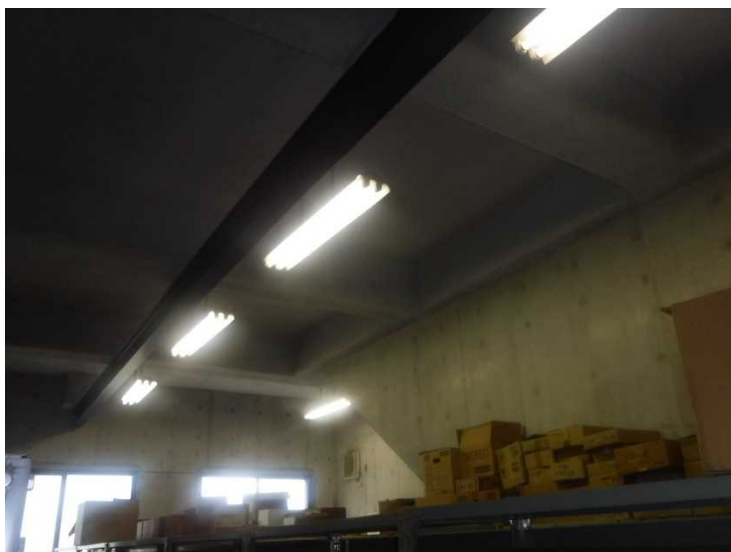
1階予備発棟書庫(⑧:5基、⑨:3基)
