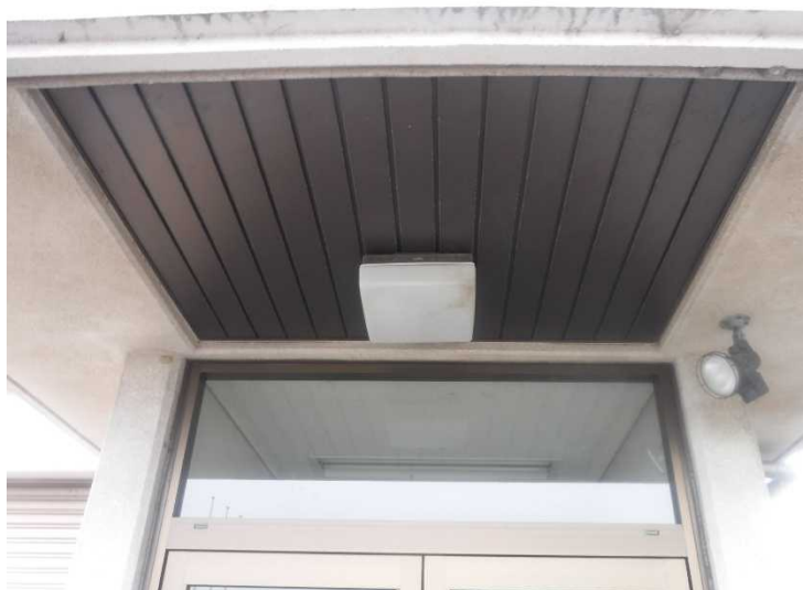
ポーチ(③:1基)
