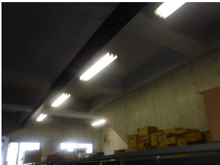
1階予備発棟書庫(⑧:5基、⑨:3基)
