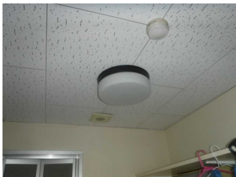
1階 脱衣所(⑦:1基)
