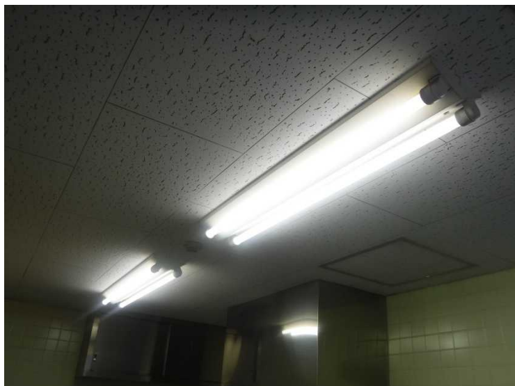
1階 厨房(④:2基)
