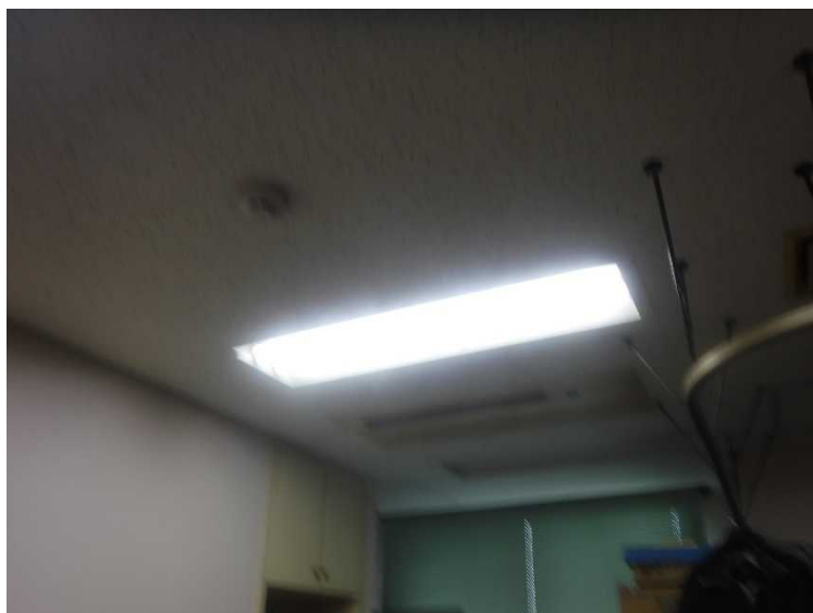
1階 食堂(①:2基、②:1基)
