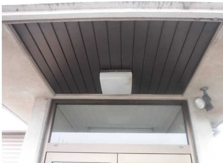
ポーチ(③:1基)
