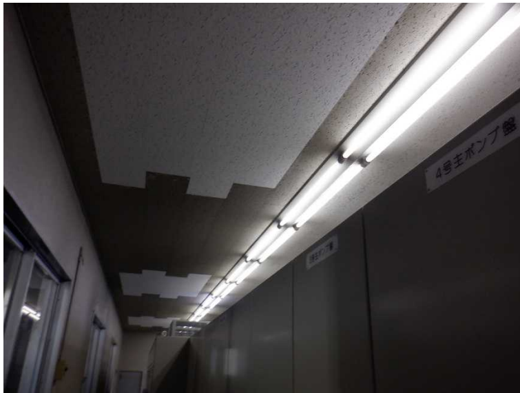
2階電気室(②:24基)
