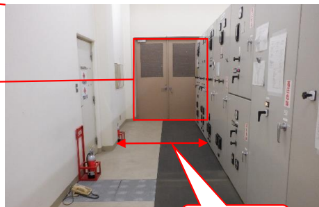
電気室内通路
