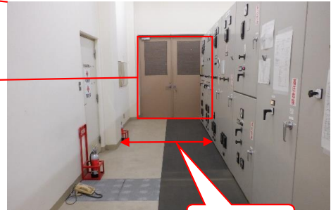
電気室内通路
