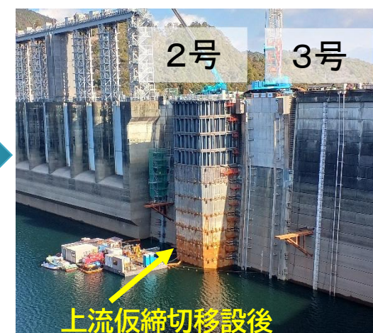
2号の設置状況
