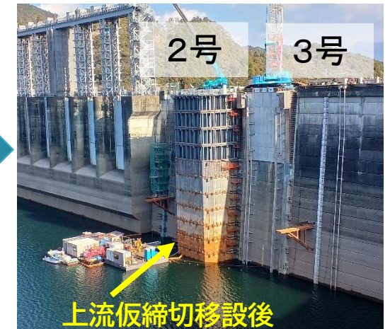
2号の設置状況
