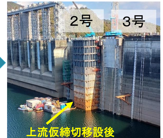
2号の設置状況
