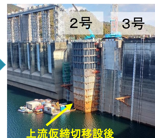
2号の設置状況
