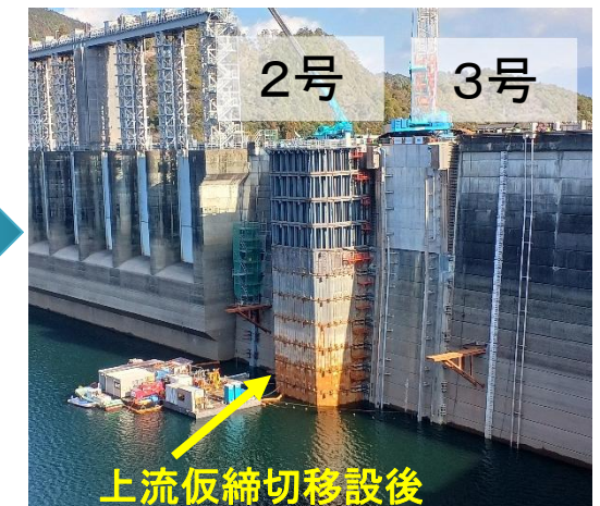
2号の設置状況
