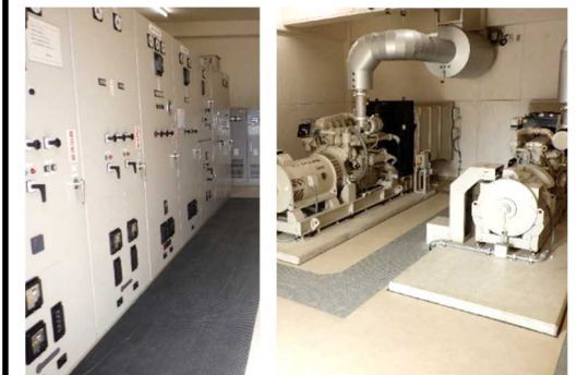
既設受変電設備
