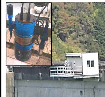
既設水質自動観測設備 (建屋)
