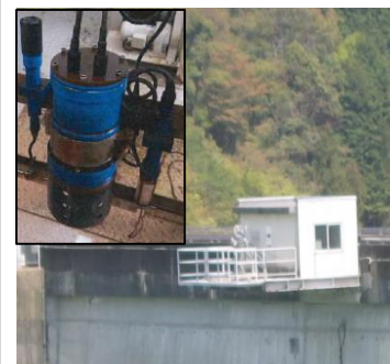
既設水質自動観測設備 (建屋)
