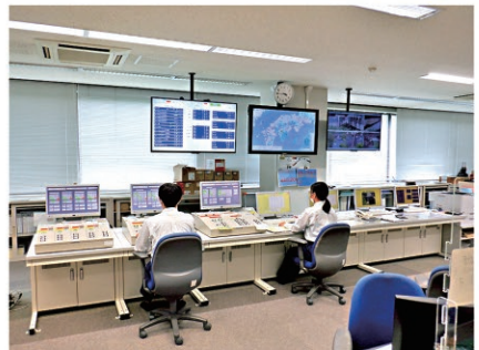
富郷ダム操作室
