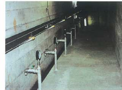
基礎排水孔/揚圧力測定装置
