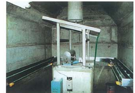
堤体変位計(ブラムライン)
